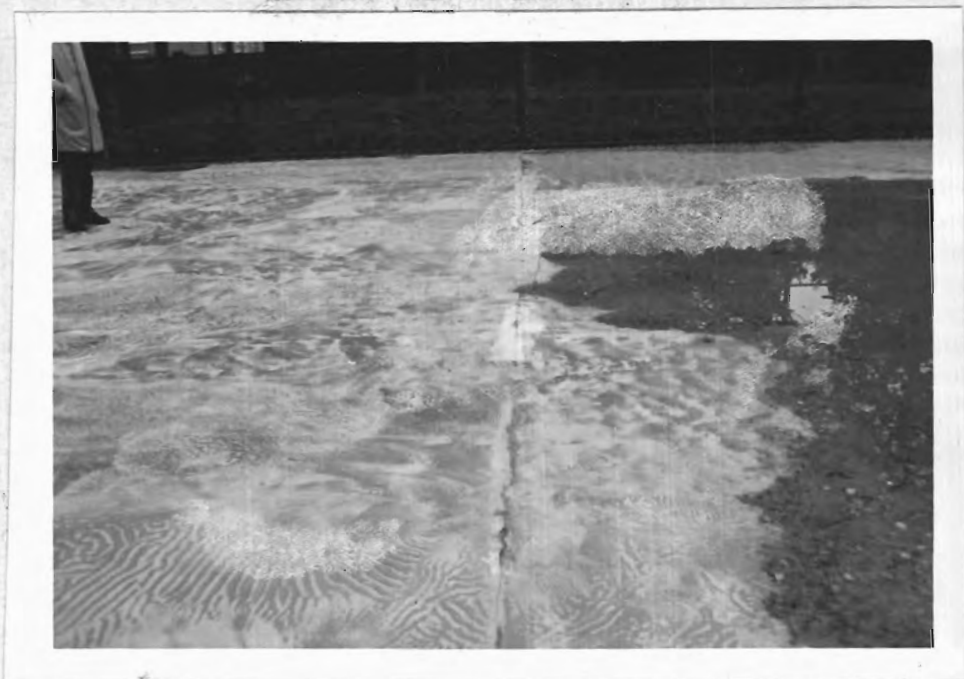
Obr. 3 * Trhlina ve vrchní krytině nad dilatační spárou plastbetonu
