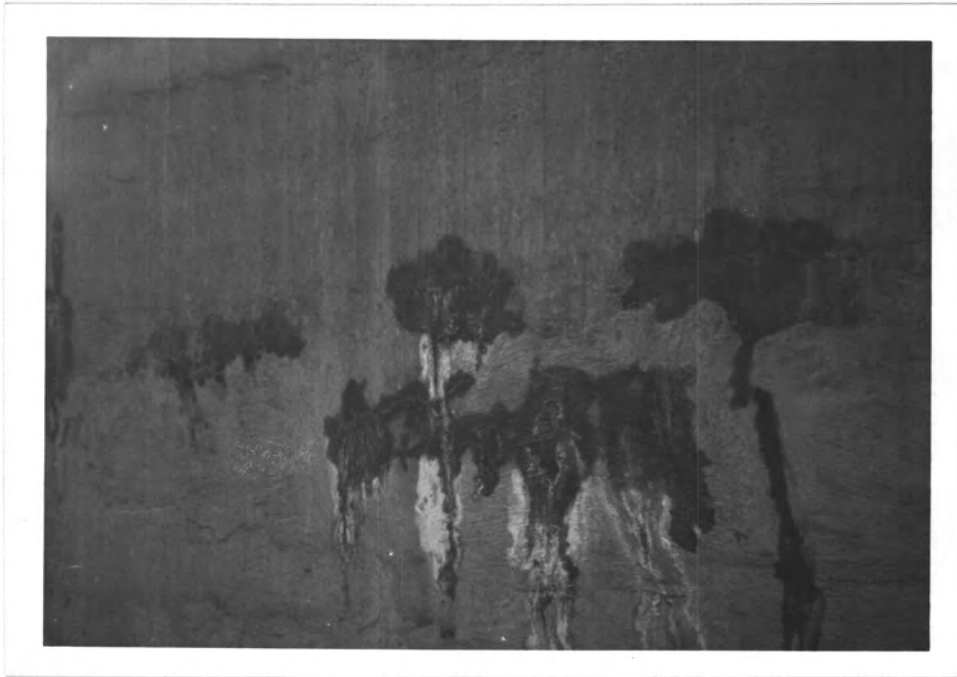
Obr. 10 Prásky v oblasti rásných nehomogenit betonu
