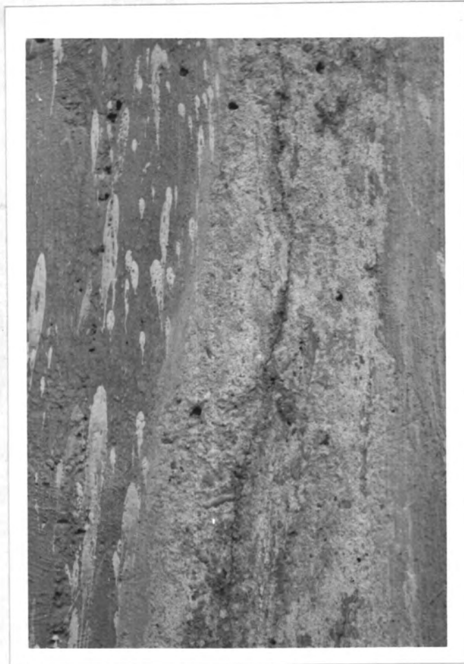
Obr. 6 Detail svislé trhliny na věži č. 2 (po vyprázdnění sítě a vysušení)
