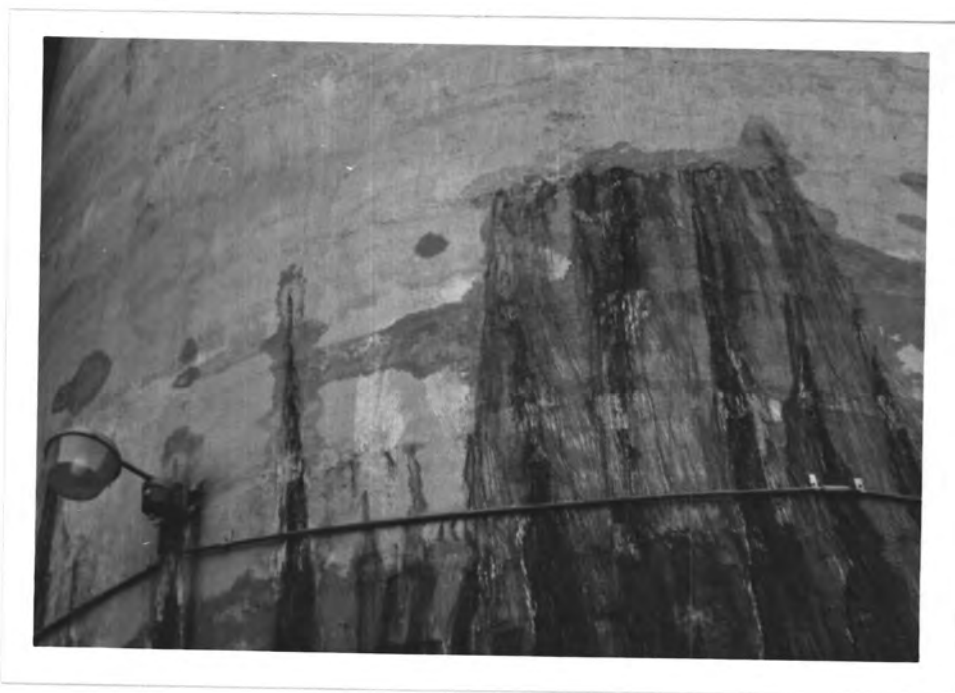
Obr. 8 Průsaky vodorovnými trhlinami na věži 8. 12
