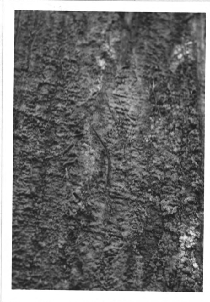
Obr. 7 Detail svislé trhliny na věži č. 12
