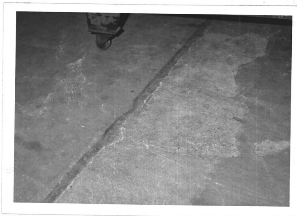
Obr. 6 - Poruchy podlahoviny u dilatačních spar
