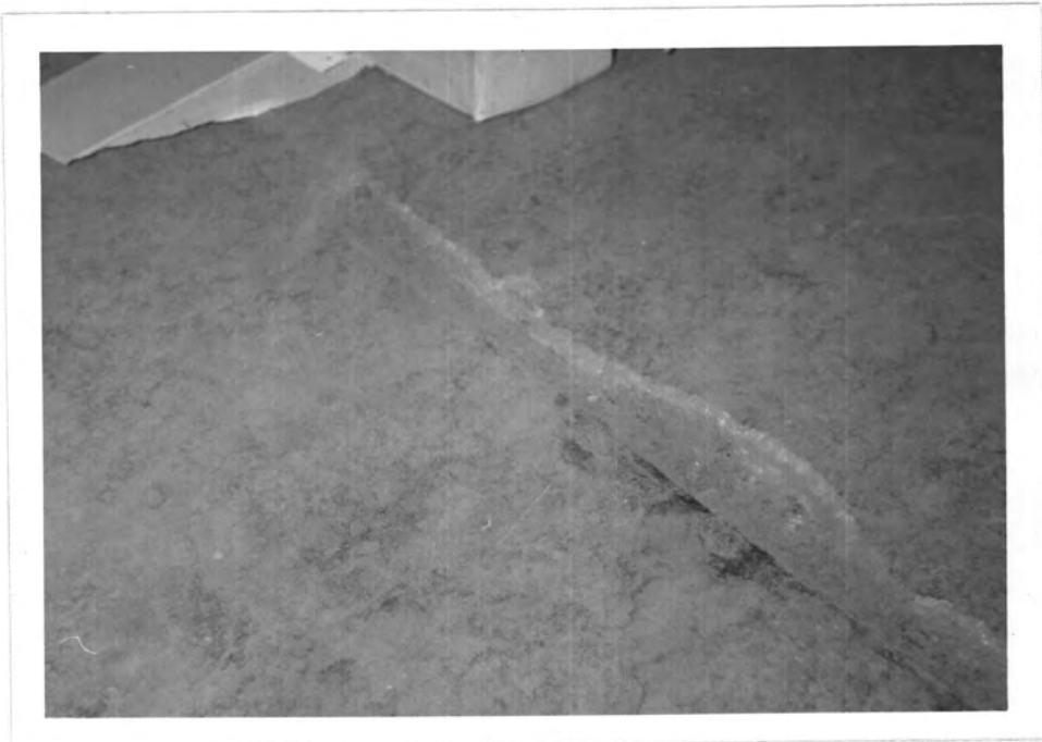
Obr. 4 - Poruchy podlahoviny u dilatačních spár
