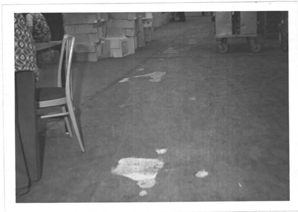
Obr. 7 - Poruchy podlahoviny na zdánlivě náhodných místech
