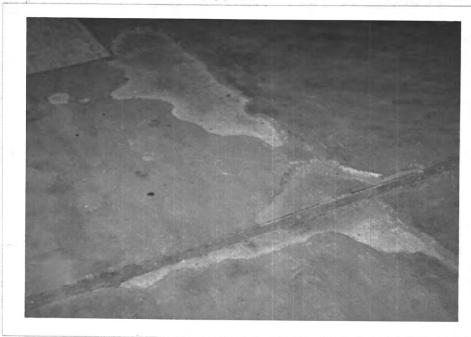
Obr. 5 - Poruchy podlahoviny u dilatačních spar
