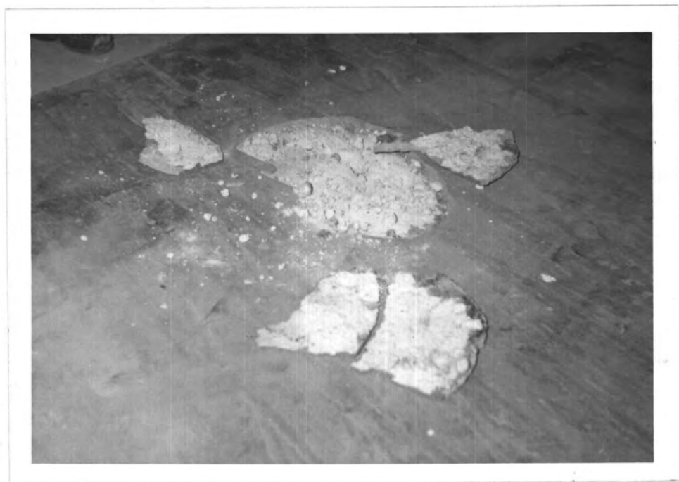
Obr. 8 - Poruchy podlahoviny v místech porušeného podkladního betonu
