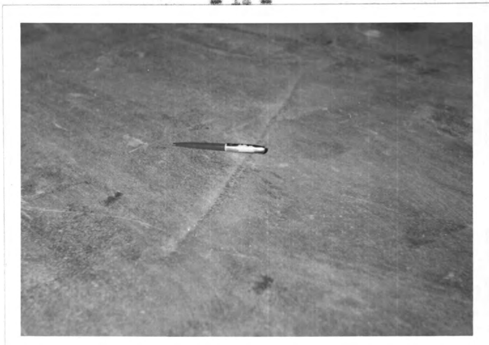
Obr. 3 - Značné nerovnosti povrchu podlahoviny zejména v místech pracovních spár
