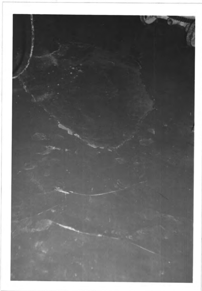
Obr. 8 Vznik trhlin od pro- ražených míst
