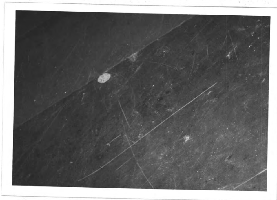
Obr. 3 Poruchy /promáknutí/ ve staré podlahovině na styku s novou
