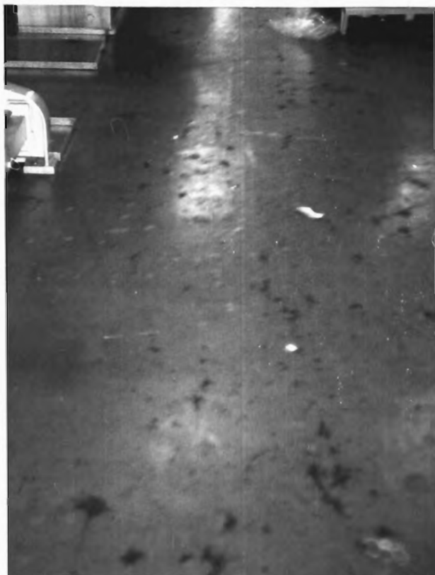
Obr. 4 Proražení výdutí s vytékající pryskyřičnatější kapalinou na transportních cestách v plotárně
