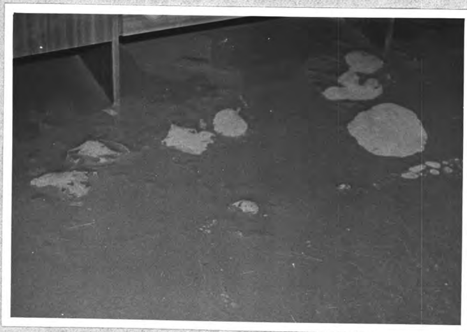
Obr. 5 Odloupávání povrchové vrstvy podlahoviny ve společenském sále
