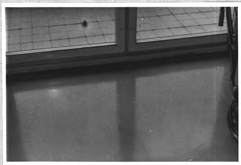
Obr. 1 Úroveň balkonů /lodžii/ je zvýšena proti úrovni místností o cca 10 cm
