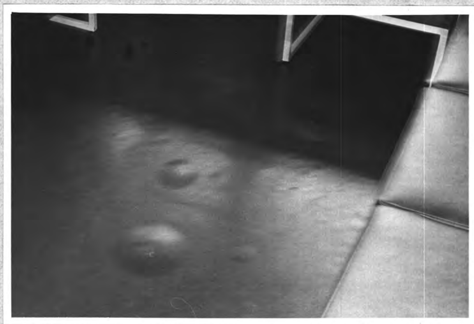
Obr. 2 Velké výdutě v podlahovině v některých místnostech
