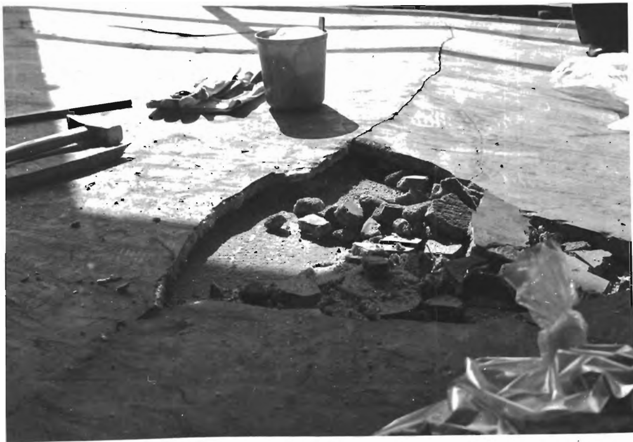
Obr. 5 Trhlinami porušená podlahovina rampy s konvexním vydatím okrajů.
