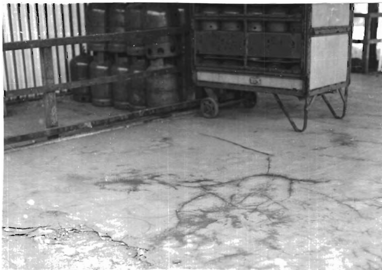
Obr. 6 Trhlinami porušená podlahovina v hale svědčící o snížené pevnosti nosné vrstvy plastbetonu a průniku vlhkosti a podkladního betonu.
