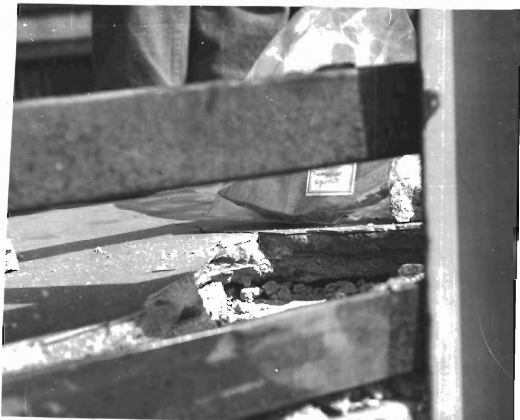
Obr. 2 Detail porušené podlahoviny, oddělené od konstrukčního betonu spolu a podkladním cementovým potěrem
