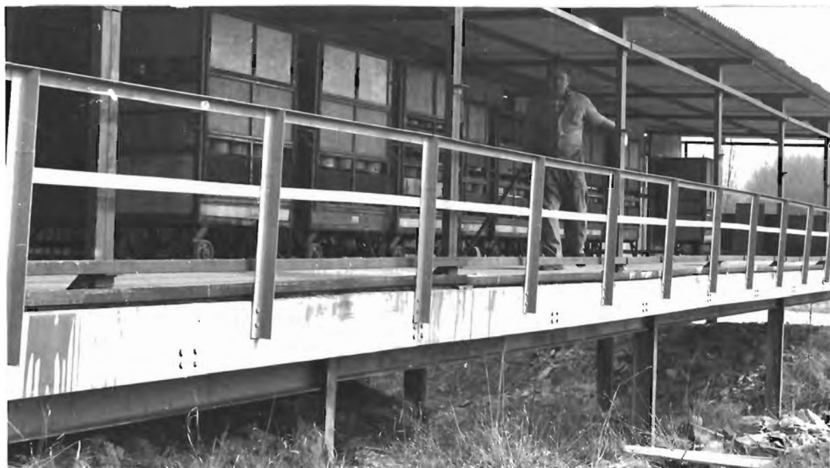
Obr. 1 Pohled na rampu s oddělenou podlahovinou a podkladním cementovým potěrem od konstrukčního betonu
