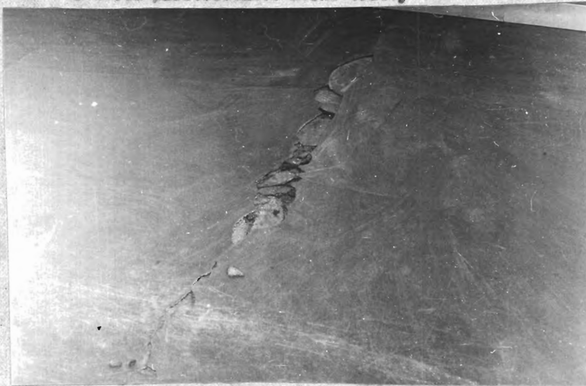
obr. 1 Typické trhliny podlahoviny v konzolové části stropní konstrukce v blízkosti sloupů, kolmé k obvodu. Po vzniku trhliny dochází k místovitému zdvižení povrchové vrstvy a části plastbetonové nosné vrstvy
