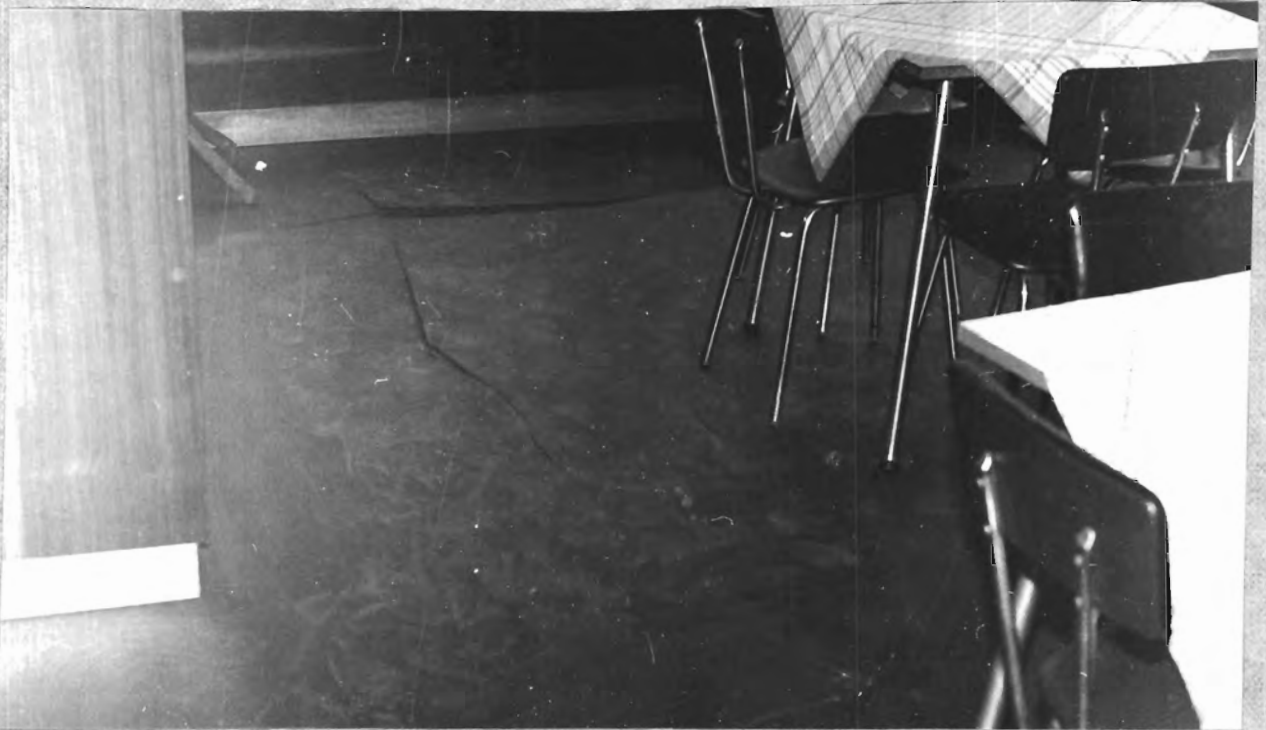
Obr. 5 Trhliny probíhají rovněž rovnoběžně s obvodovými stěnami v konsolové části stropní konstrukce, vzniklé ve směru profilů, zbraňujících nadzdvihávání plechů
