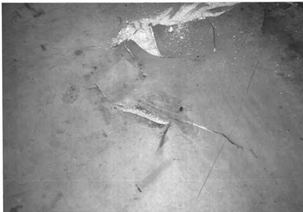
obr.3 Popraskání povrchové vrstvy ve výdutích
