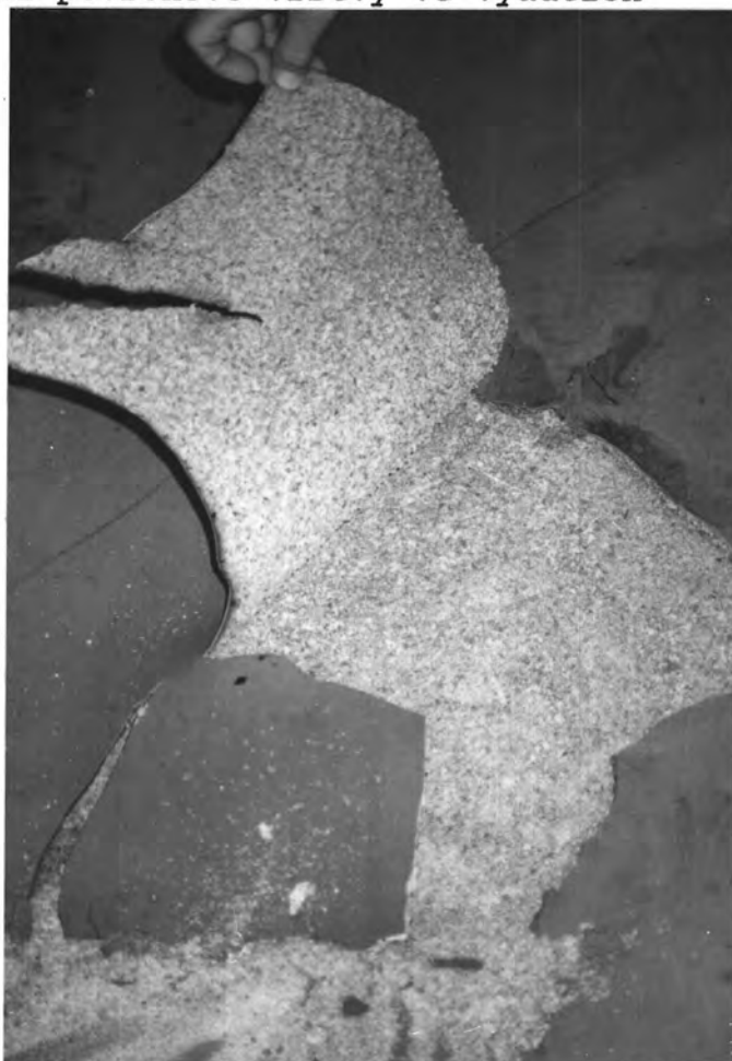
obr.4 Popraskaná a změklá povrchová vrstva
