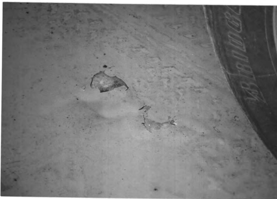
obr.1 Místní oddělení povrchové vrstvy od polymerbetonu v umývárně
