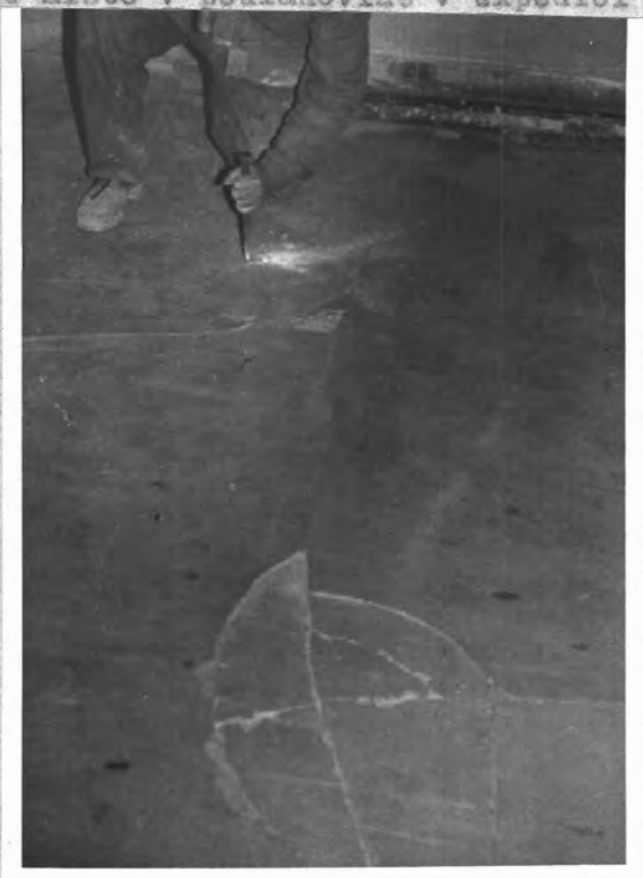
Porušená podlahovina v expedici /224/
