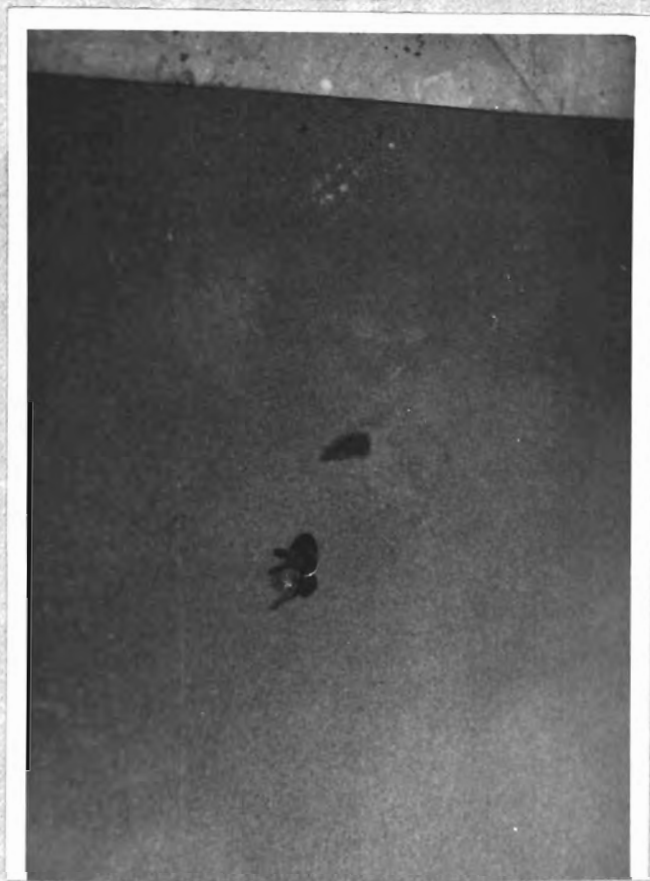
Obr. 12 Znovu položený plastbeton v místnosti 570/bez povrchové vrstvy/ nepevný
