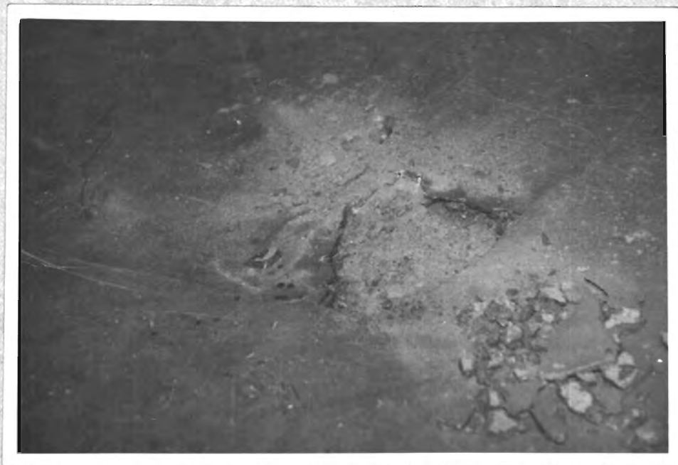
Zcela porušená podlahovina na rôznych miestach chodby 192
