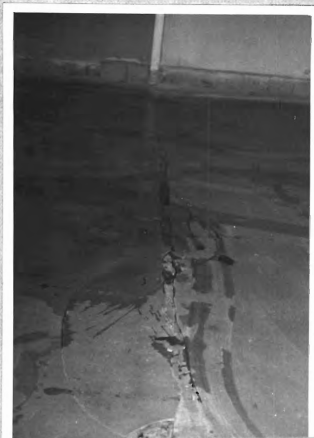
Obr. 18 3 Trhlina v místě dilatace v chodbě 192
