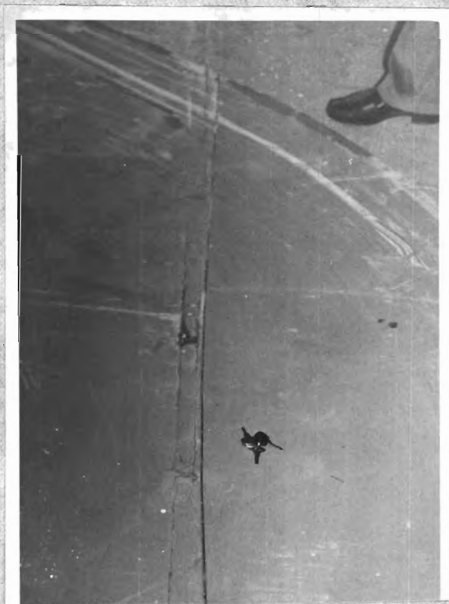
U nesprávně provedené dilatace v křížení chodeb 196 a 197 se okraje podlahoviny zdvihají
