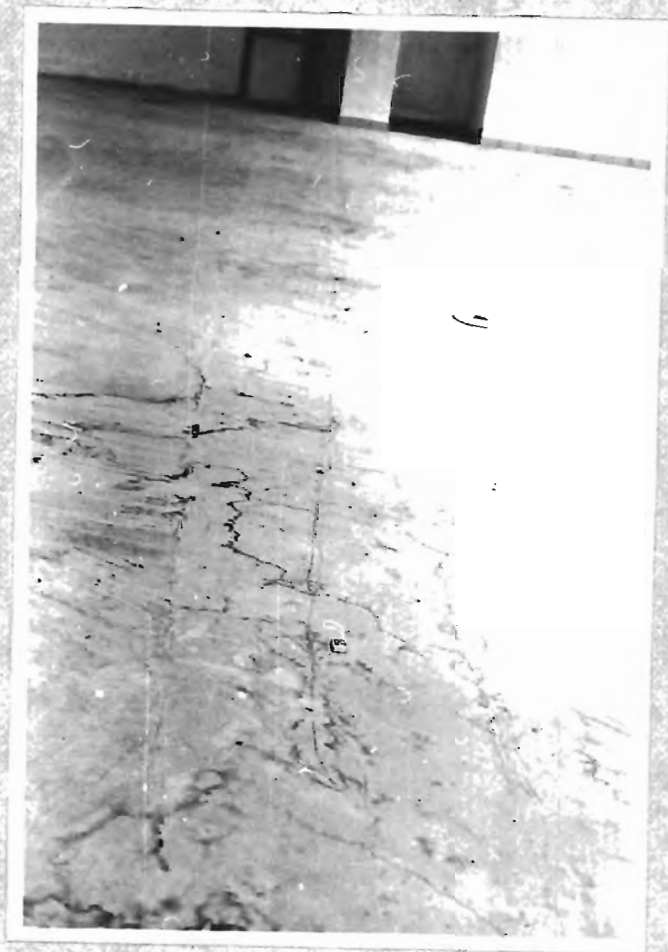
Str. 27 - obr. 1 přímé trhliny v podlahovině obr. 2
