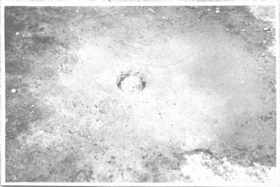
Obr. 4 Rozpadavý beton s nemožností získat ostře ohraničený vývrt /loď 3/
