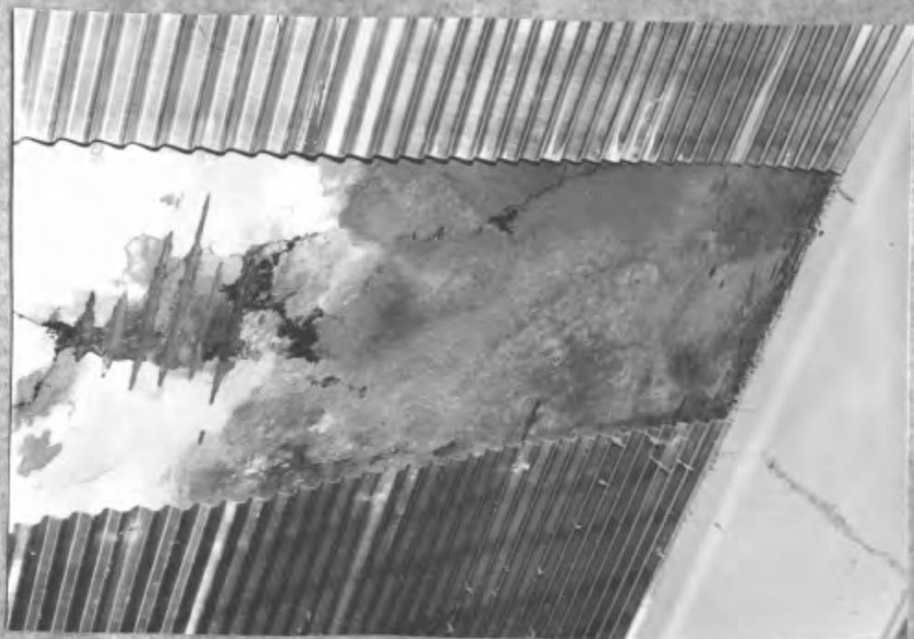
Obr. 5 Detail popraskaného a oleji promáčeného betonu obnažené části stropu na druhém místě
