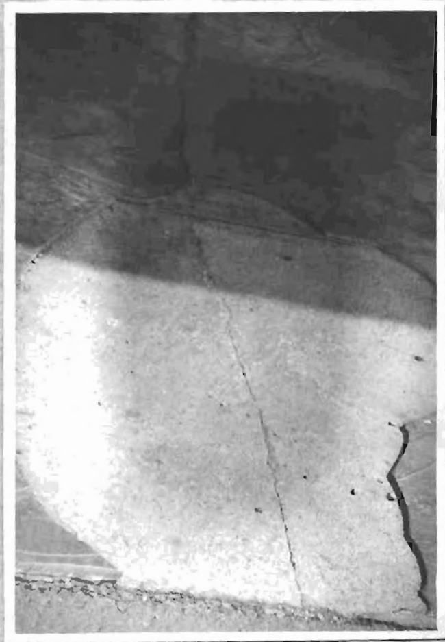
Obr. 3, 4 Poruchy na rampách /SO 209/
