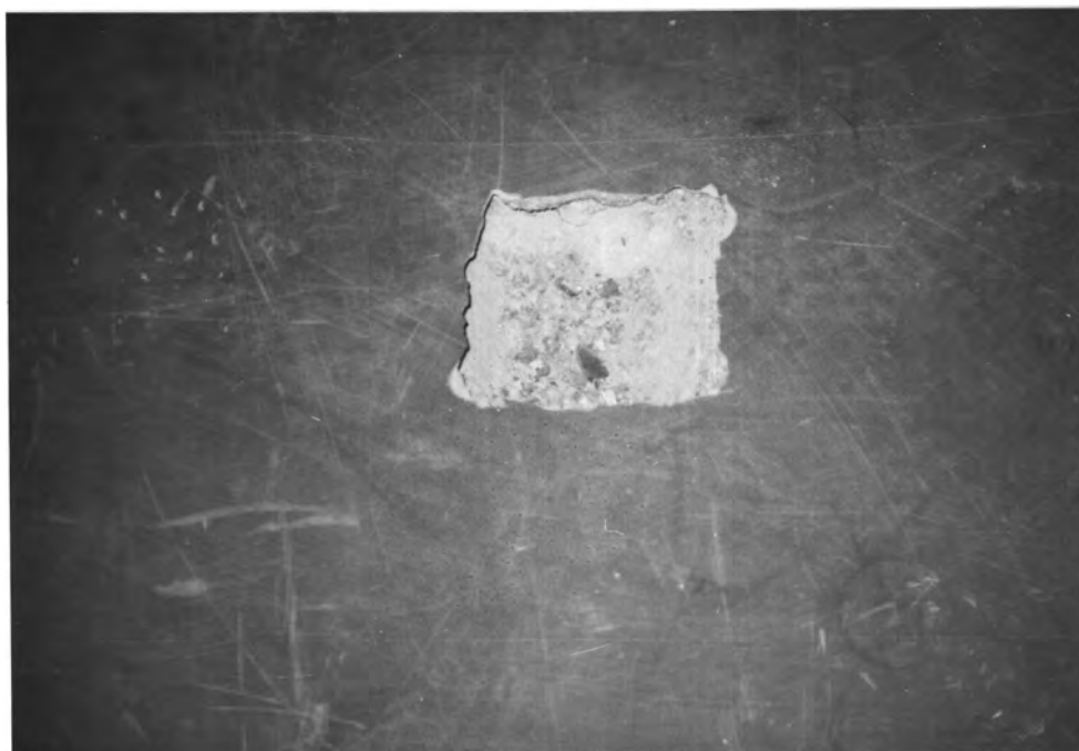
obr.5 Místo odběru vzorku podlahoviny pod výdutí
