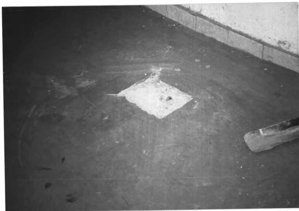
obr.6 Místo odběru vzorku podlahoviny mimo výduť
