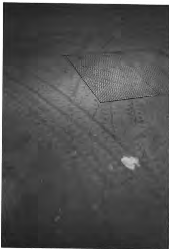
Obr. 5 Trhliny od rohů šachet
