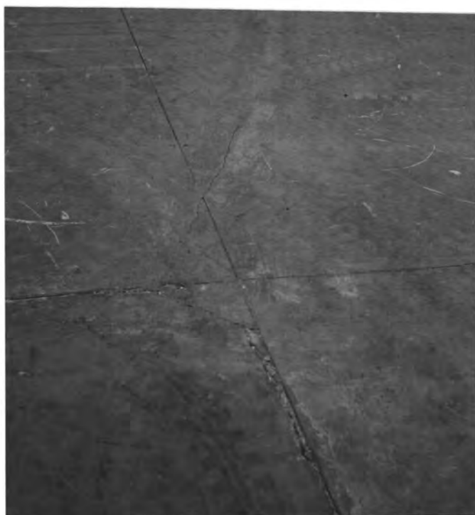
Obr. 1 Průběžná trhlina přes několik polí
