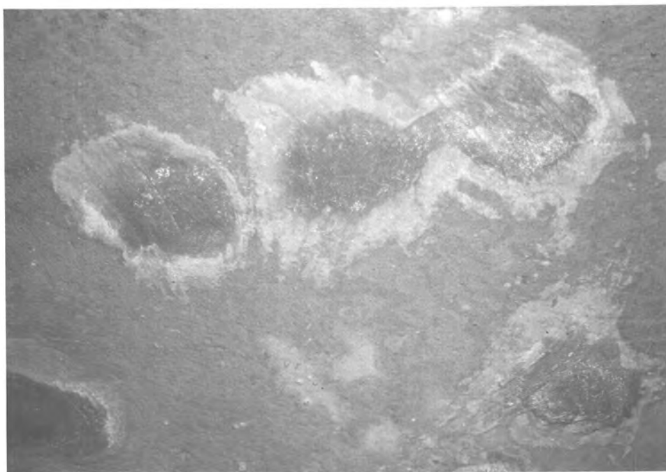
obr. 1 – Opravovaná místa betonové mazaniny se zdánlivými výrony vody
