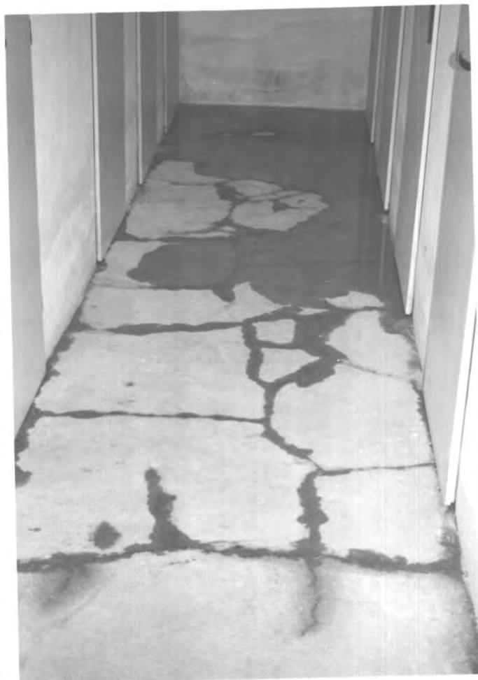
obr. 2 – Promáčená a popraskaná betonová mazanina, výron vody ve stěně
